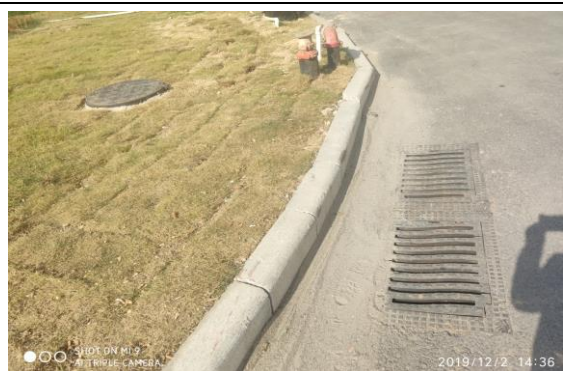
图 19: 雨水管及篦子现状
