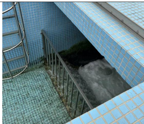
污水排放采样口
