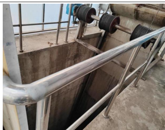
污水进水采样口
