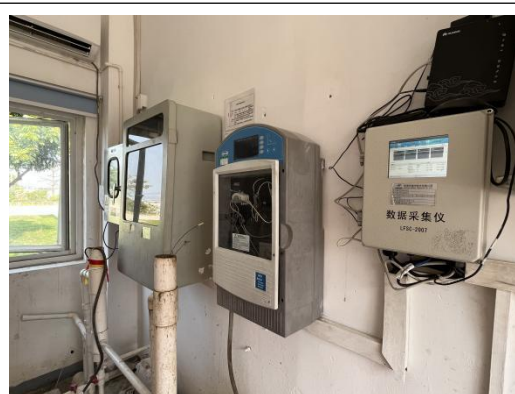
进水管线仪表间及监测设备
