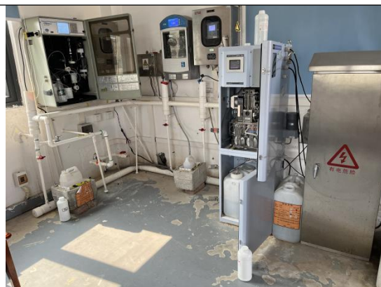
出水在线仪表间及监测设备
