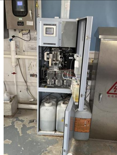
总磷&总氮在线监测设备
