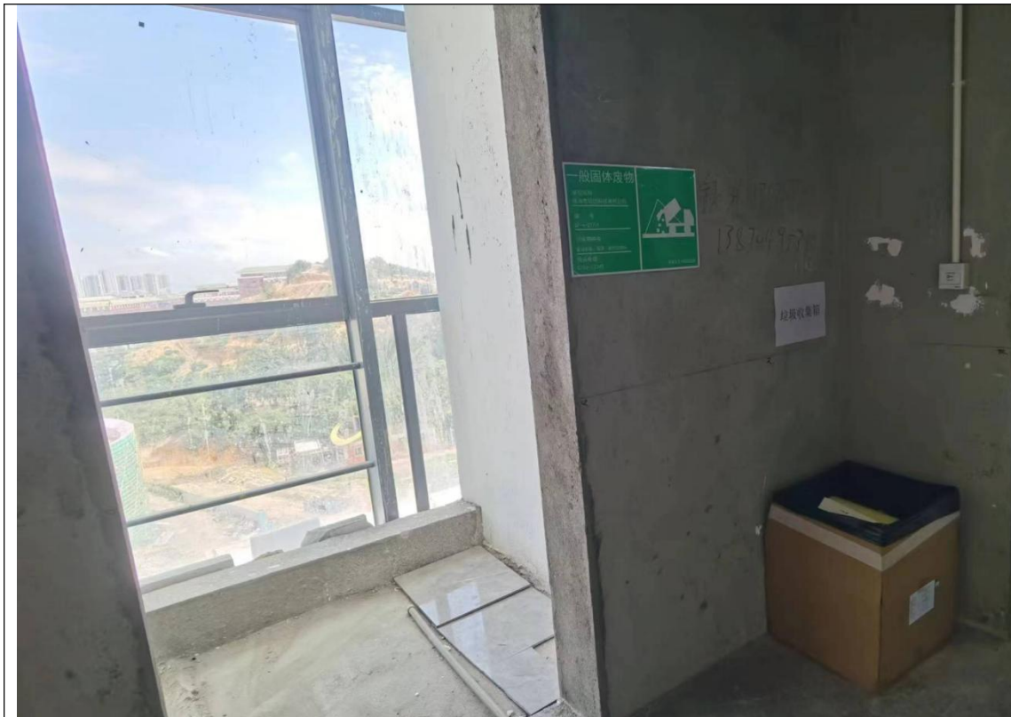
GF-6-277-1 一般固废贮存场所标志牌
